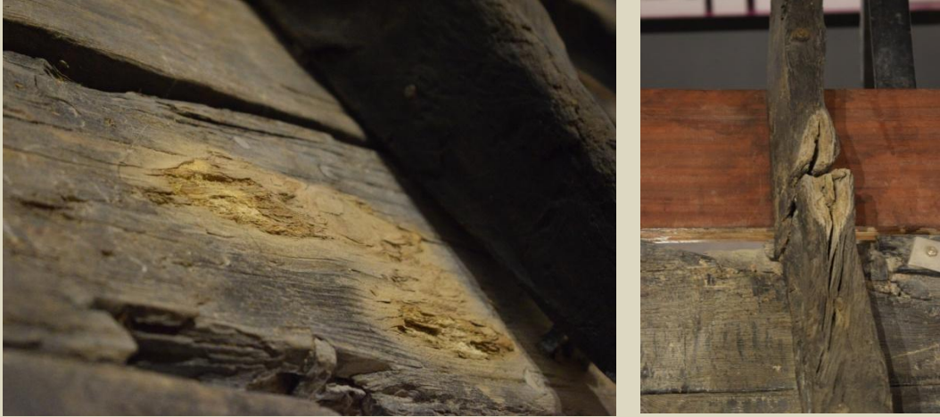
Forme di degrado localizzate che danneggiano strutturalmente gli elementi lignei
