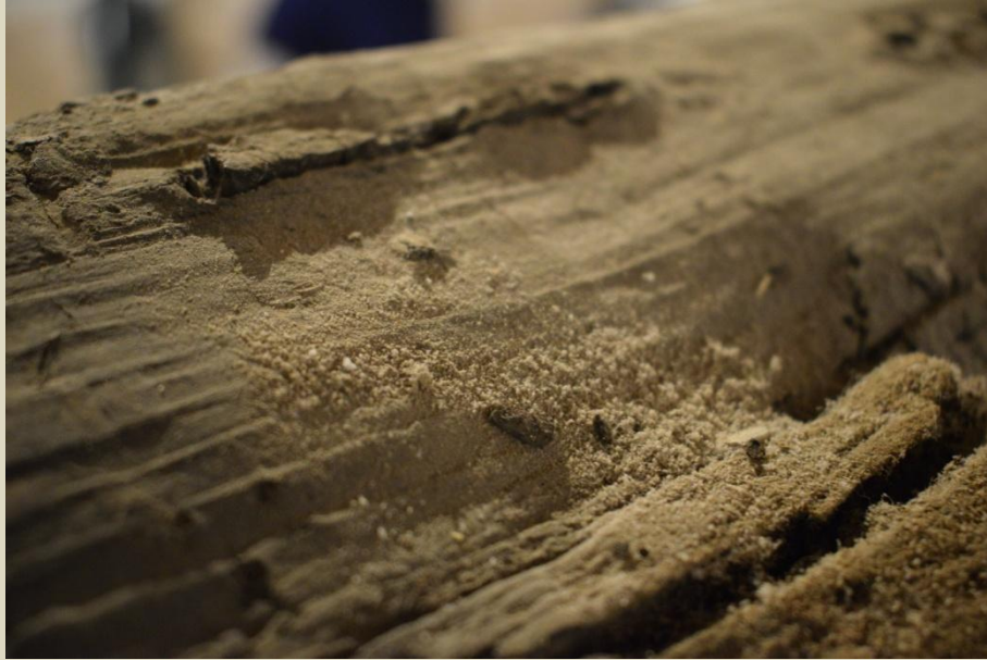
Dettaglio sulla consistenza e spessore del diffuso deposito superficiale
